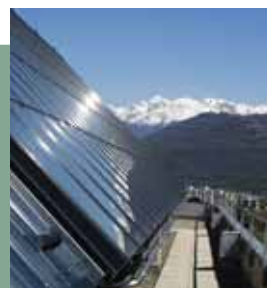
Panneaux solaires, quartier Surieux à Échirolles.
