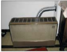
ancienne installation: 1 poêle /appartement
