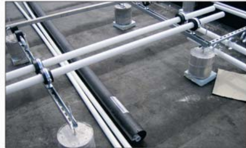
réseaux de chauffage en toiture
