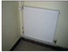
nouvelle installation: 1 radiateur/pièce
