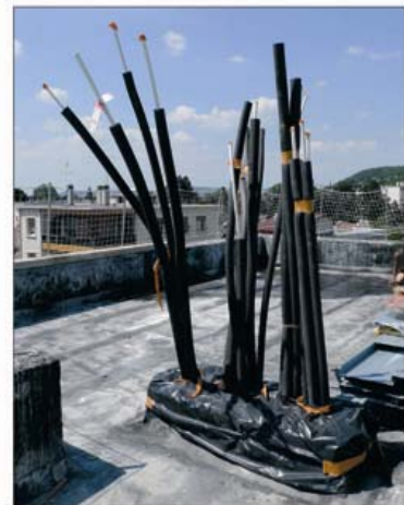
utilisation des conduits existants
