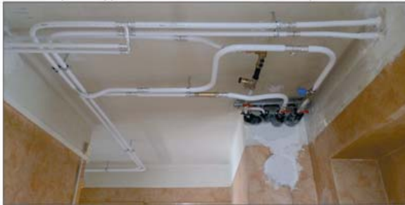
distribution Intérieure du chauffage depuis le hall
