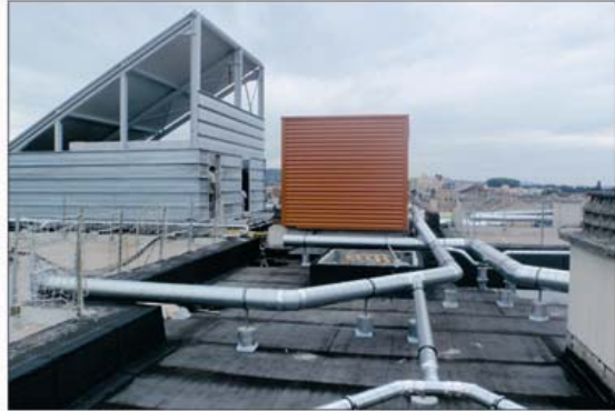
réseau ventilation double flux en toiture
